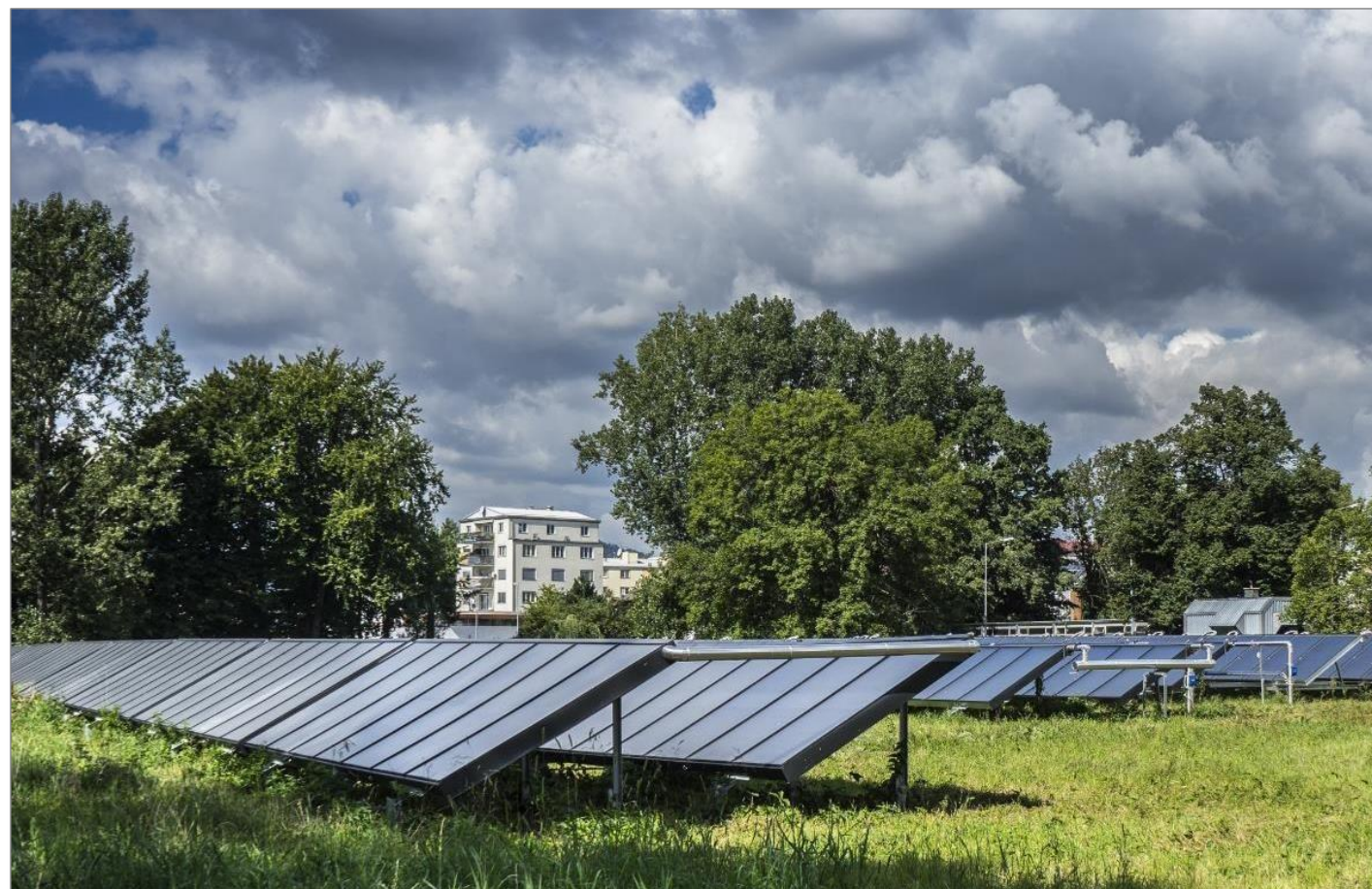
Fernheizwerk Graz (FHW) Source: Picfly.at Thomas Eberhard
