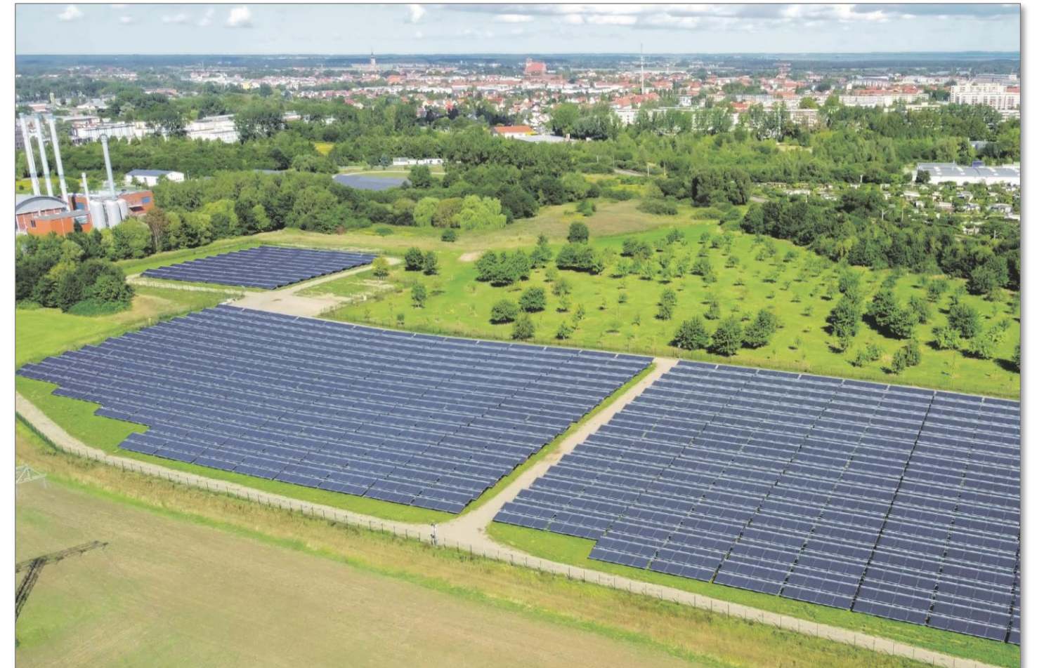
Stadtwärme Greifswald Source: Ritter XL Solar
